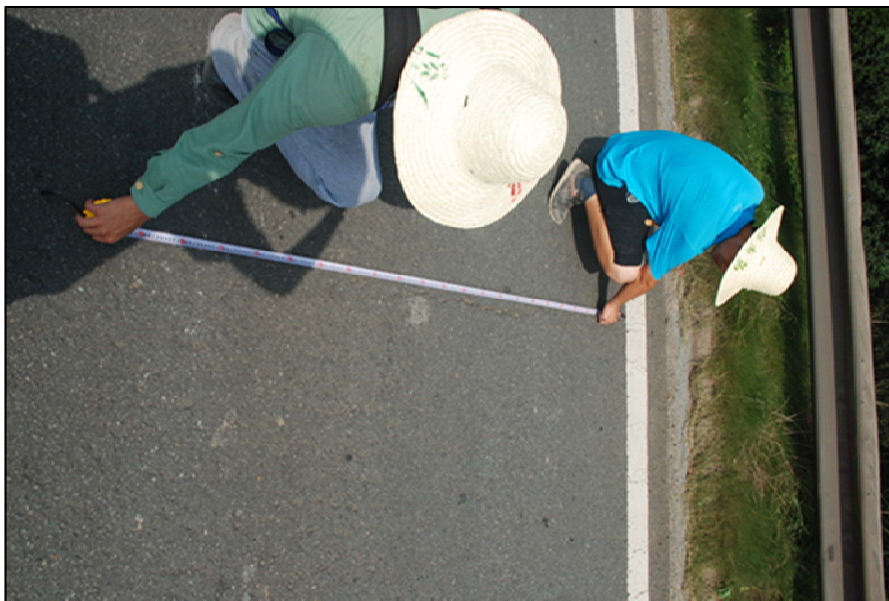
图 2.5 结构层损坏状况调研
