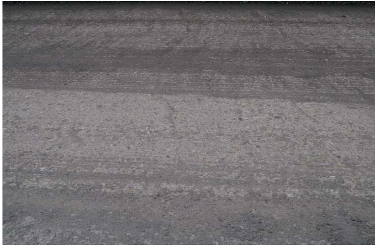
图 2.21 B 类损坏半刚性基层
