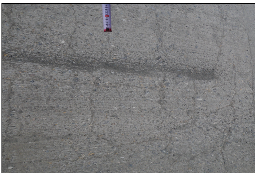
图 2.12 昌樟高速基层损坏状况 (K49+100~K49+200)
