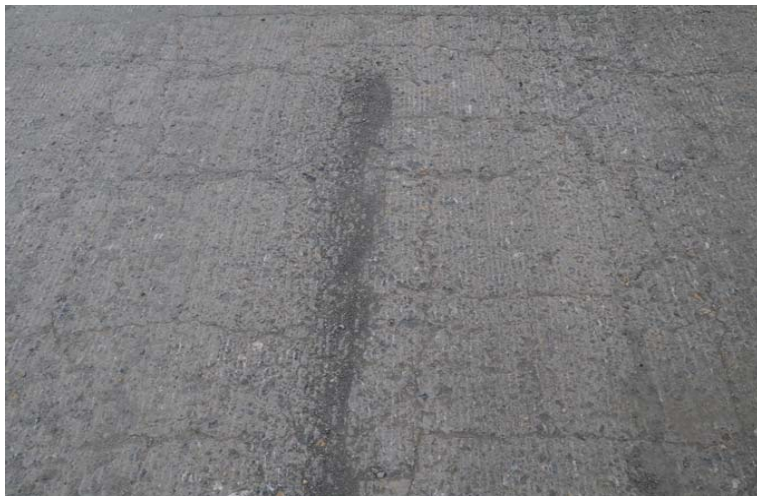
图 2.23 D 类损坏半刚性基层
